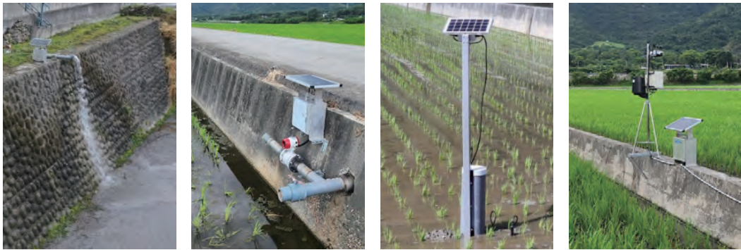
圖3、示範場域設置儀器設備包括：出入水口電子流量計、田間水位計、氣象站
